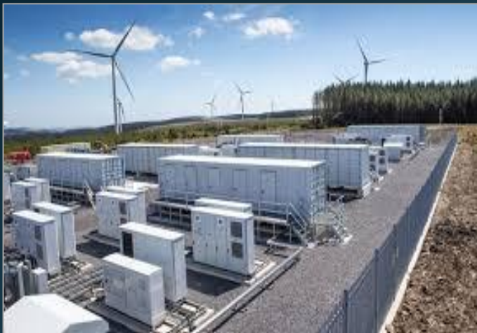
Almacenamiento de Energía
